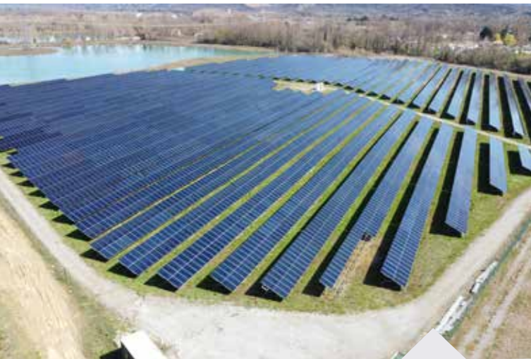
La nouvelle centrale photovoltaïque viendra compléter celle déjà en place
